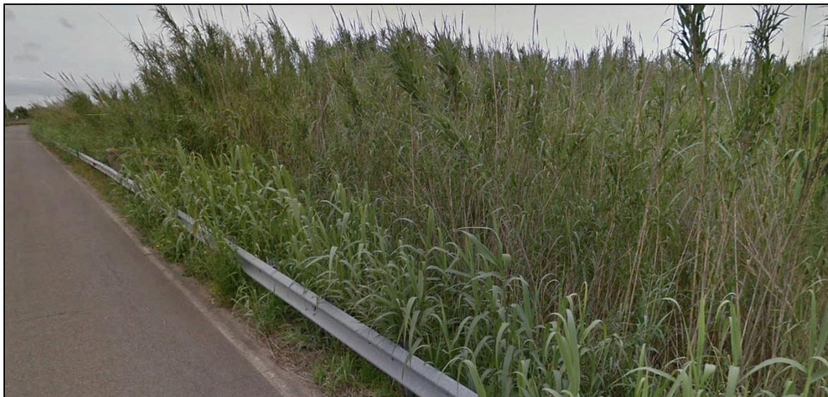
Figura 2-3 – Attraversamento della SP 123, vista lato valle con vegetazione che ostruisce il deflusso
